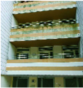
Der berühmte „Vorher-Nachher-Effekt“: Die dunklen Schlieren auf der Fassade gehören bald der Vergangenheit an.
